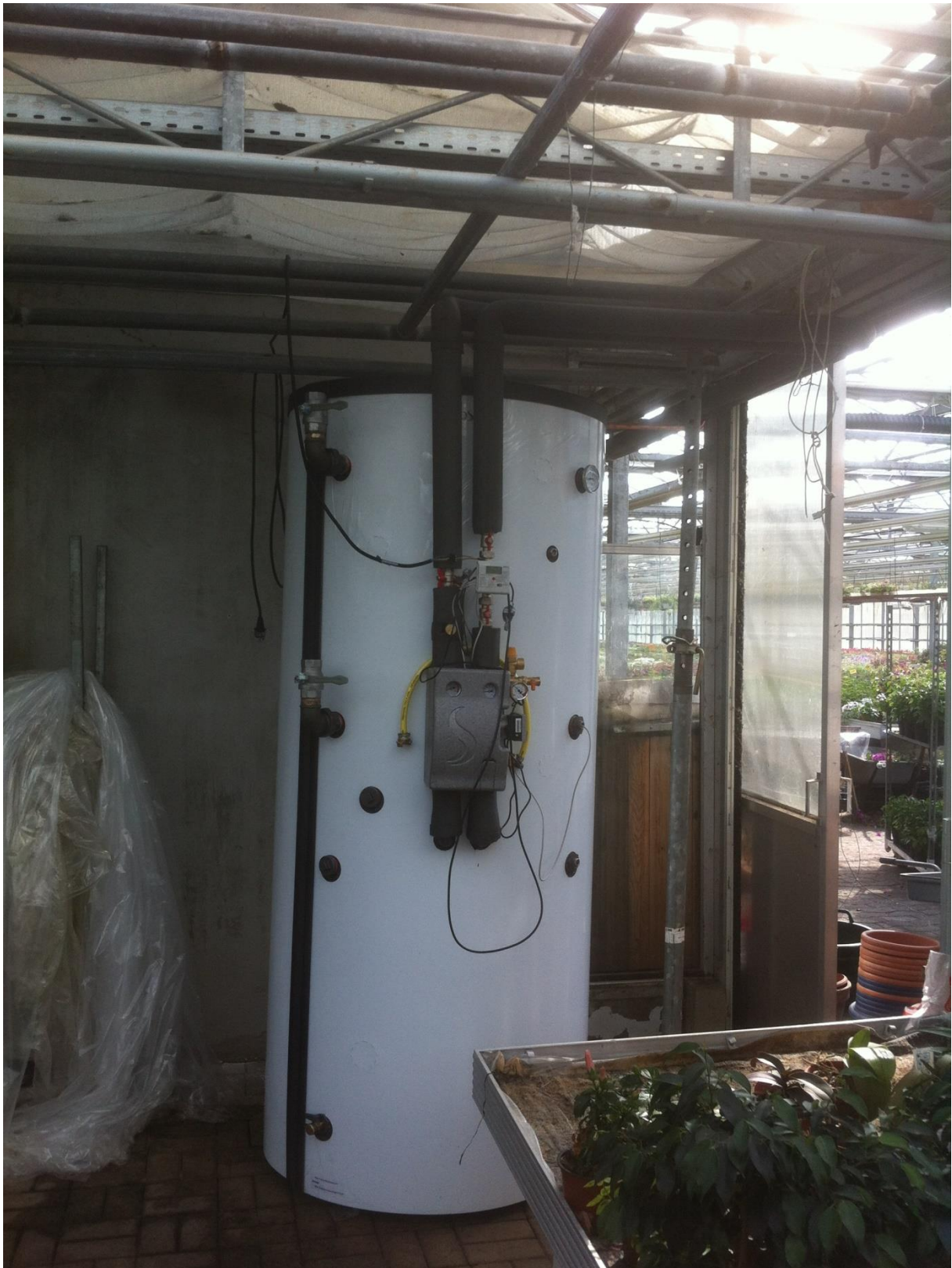
Im 1000 Liter Speicher wird die Wärme gesammelt und bei Bedarf entnommen
