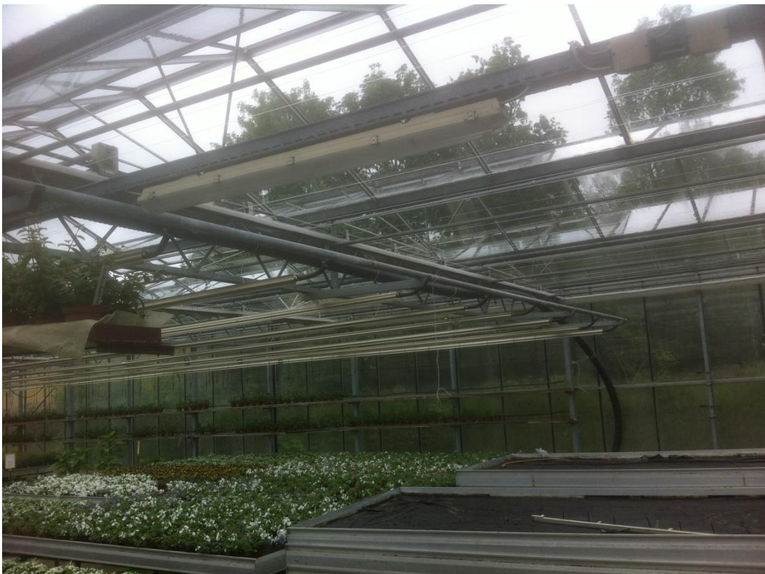
Teilweise muss die Leitung hochverlegt werden
